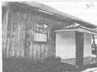
Fig. 02: Rua Joaquim de Castro. ¶ Casa sem pintura recente e sem manutenção. ¶ Fotog. V. Ferraz
