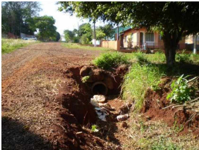
Figura 5: Feição erosiva nas laterais da Rua Pará.
