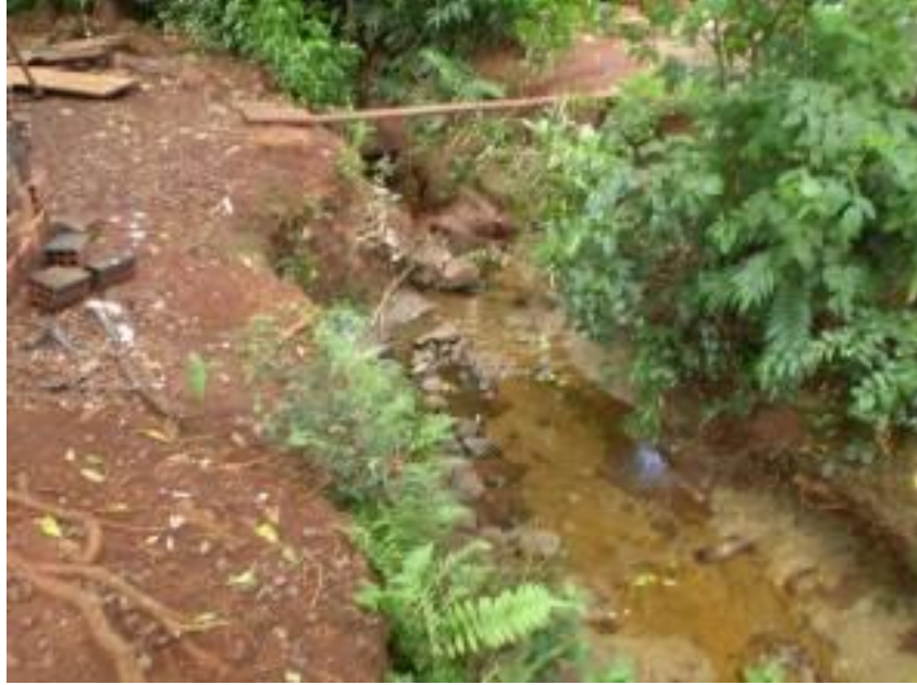
Figura 6: Feições erosivas no final da Rua Alagoas.
