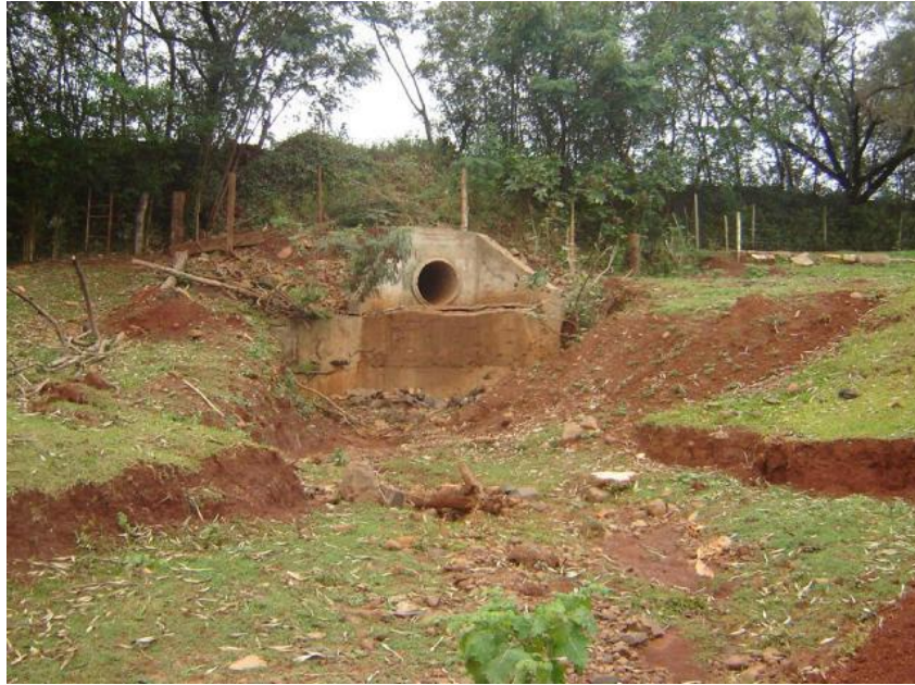
Figura 4: Início da feição erosiva nas proximidades do trevo que liga Marechal Cândido Rondon a Guaira.
