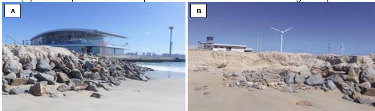
Figura 10: (A) Contenção rochosa posta para impedir o avanço marítimo nas obras do Terminal. (B) A contenção rochosa não impediu o trabalho erosivo das marés na região do perfil 01
