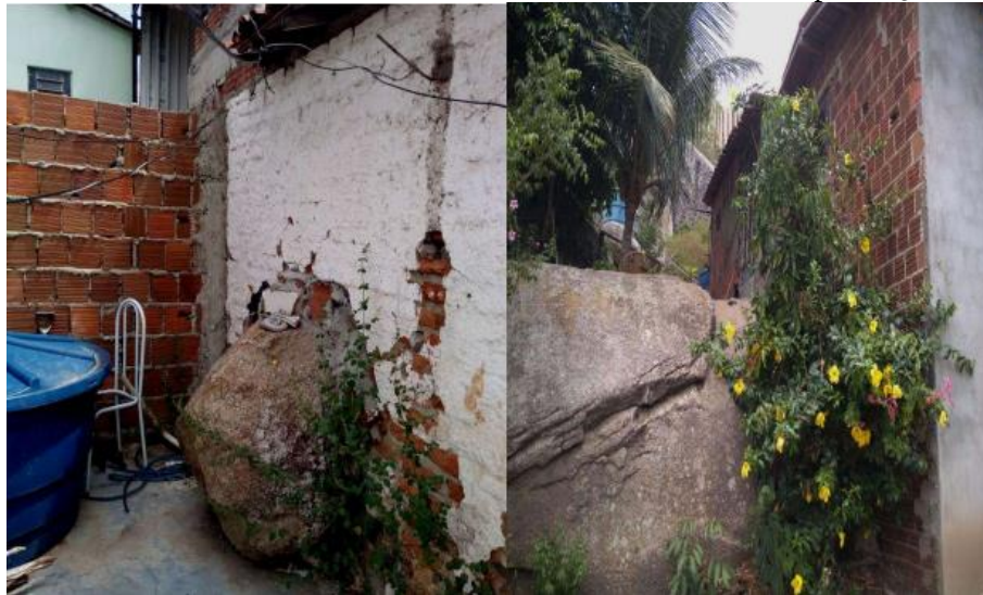
Figura 9: Rolamento de rochas nas residências na Serra de Bodopitá, Queimadas/PB
