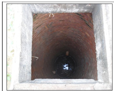
Figura 10 – Poço de armazenagem de chorume
