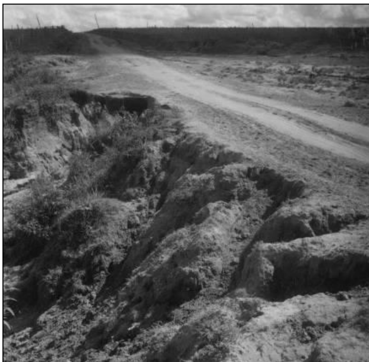
Figura 01: Estrada ameaçada por processos erosivos, município de Rancharia. Fonte: Jablonsky e Vieira (1960).
