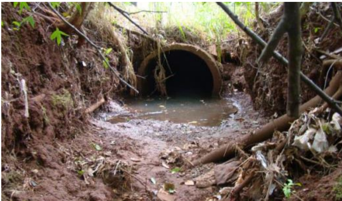
Figura 03 – Campo Mourão, Parque Gralha Azul. Emissário de galeria de águas pluviais localizado no interior do parque, 2012
