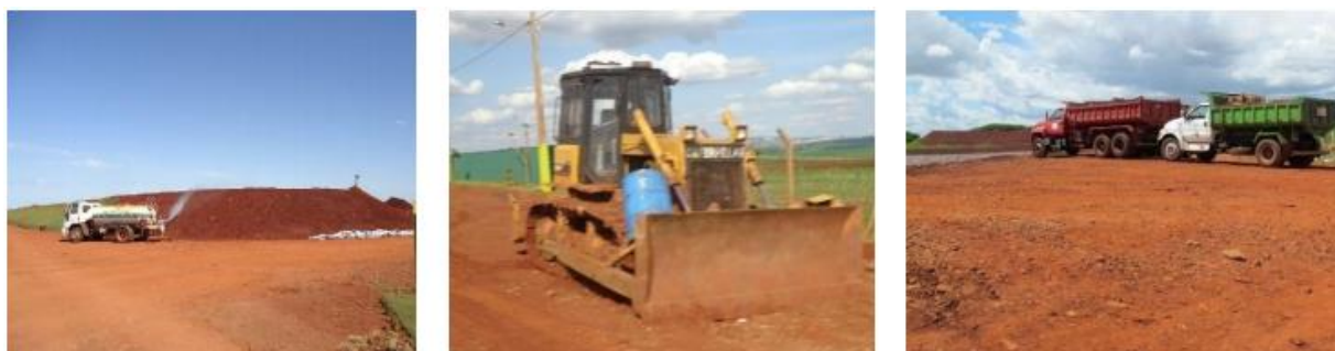
Figura 6. Equipamentos de operação existentes no aterro sanitário de Sarandi/PR
