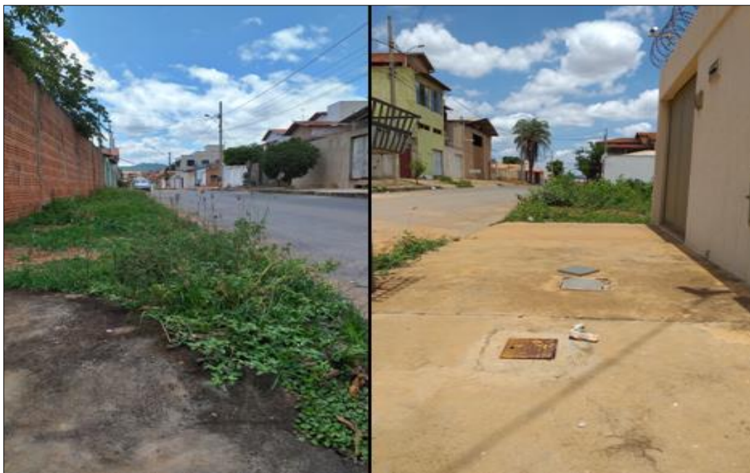
Figura 2 – Montes Claros (MG): Localização de calçadas sem pavimentação
