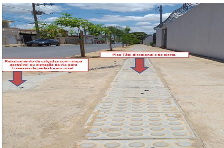
Figura 4 – Montes Claros (MG): Calçada construída seguindo as NBR 9050
