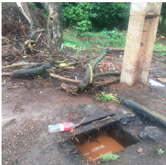
Figura 13: Terreno baldio mau cuidado e bueiro entupido com acúmulo de água parada Fonte: Autores, 2020.
