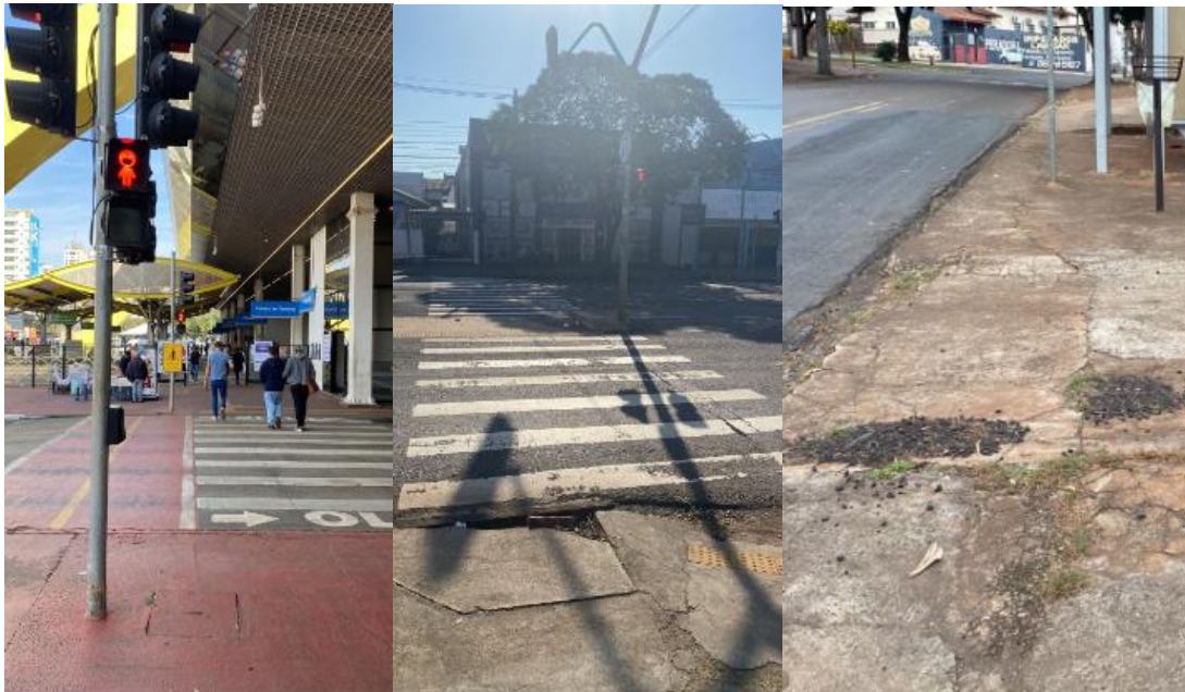
Figura 8 - Sinalização viária e condições da pavimentação de calçada em pontos de travessia
