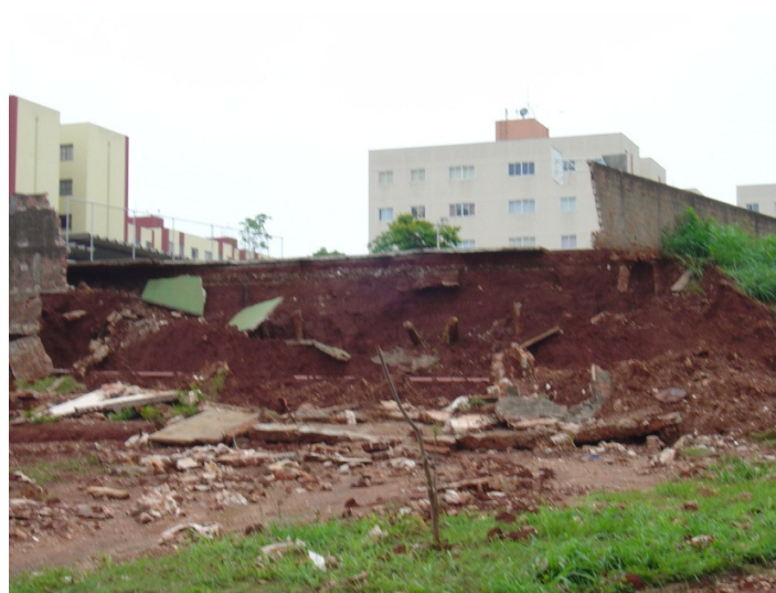
Figura 11 - Quadra sendo destruída pelo forte escoamento pluvial da alta e media vertente. Autora: Maria Teresa de Nóbrega, 2006.
