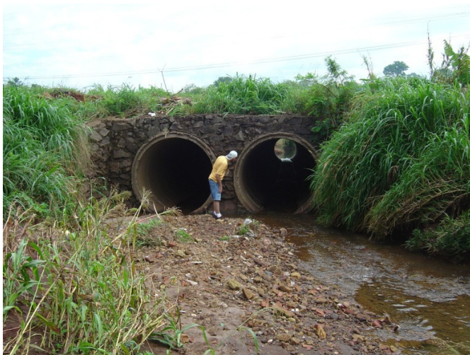
Figura 15 – Área a montante da passagem de rua, depósito de seixos e materiais que variam desde blocos de basaltos até lixo doméstico. Autora: Maria Teresa de Nóbrega, 2006.
