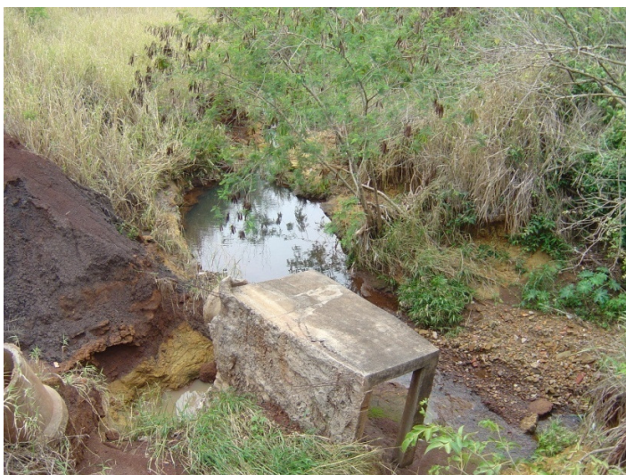
Figura 9 – Parte da galeria pluvial, e dispersor de drenagem destruída. Autora: Maria Teresa de Nóbrega, 2006.
