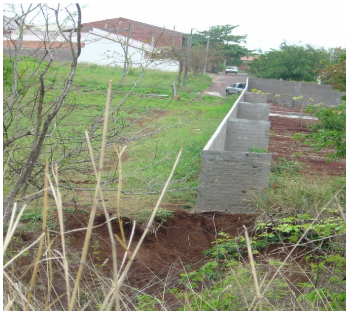
Figura 8- na margem esquerda do afluente do córrego, muro de chácara com início de queda. Autora: Maria Teresa de Nóbrega, 2006
