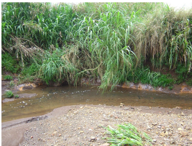
Figura16 - Material depositado e lençol aflorando. Autora: Maria Teresa de Nóbrega, 2006.
