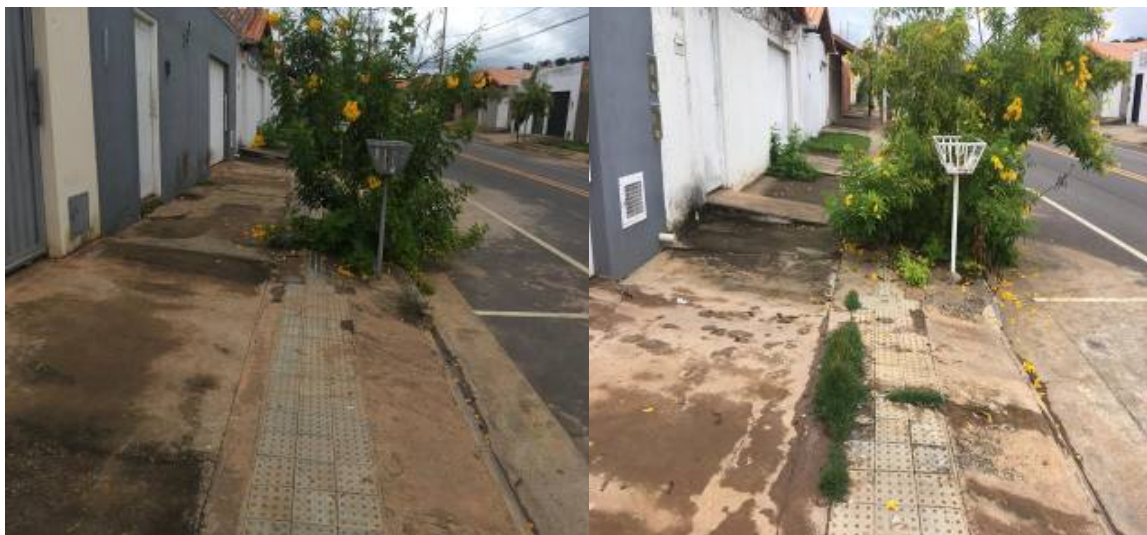
Figura 09 – Calçada obstruída por árvore com poda irregular no Bairro Residencial Sul-Ipê em Montes Claros_MG, em 2020 Fonte: Moraes (2020)
