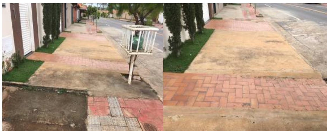
Figura 7: Diferença de Nível na Calçada Cerâmico no Bairro Residencial Sul-Ipê em Montes Claros/MG, em 2020 Fonte: Morais (2020)
