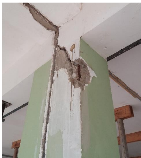
Figura 11. Pilar com a presença de rachadura, queda de revestimento e corrosão de armadura
