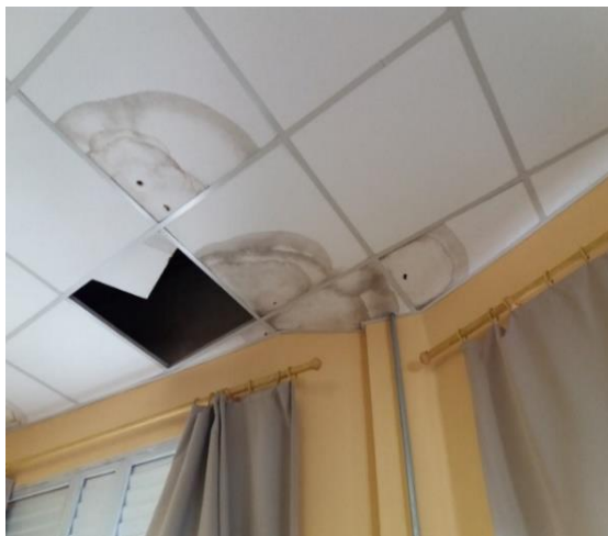
Figura 9. Queda de forros na sala 208 do prédio do pavilhão de auditórios
