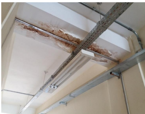
Figura 8. Infiltração na junta de dilatação ocasionando descolamento do revestimento
