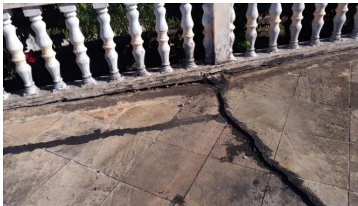
Figura 2. Trincas e medida corretiva sobre a laje do Espaço JK
