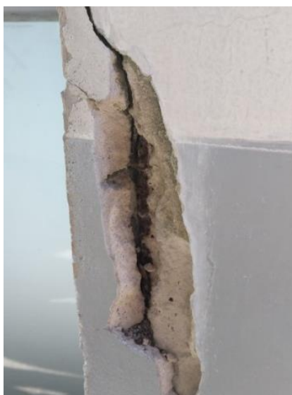
Figura 5. Corrosão de armadura em um dos pilares de sustentação do Prédio I
