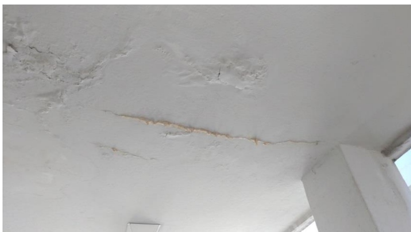
Figura 4. Eflorescências e Criptoflorescências sob a laje de cobertura de uma das áreas de circulação
