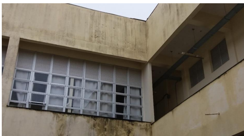
Figura 13. Trinca, infiltração e mofo na fachada interior do ICT
