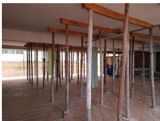
Figura 12. Laje do primeiro pavimento com reforço estrutural
