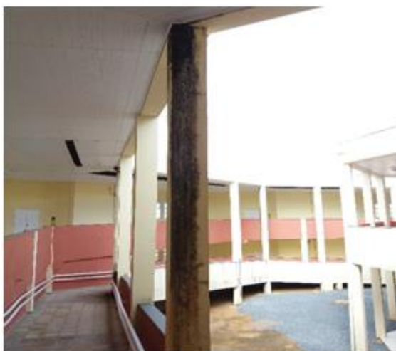
Figura 10. Infiltração e presença de lodo em pilar do pavilhão de auditórios
