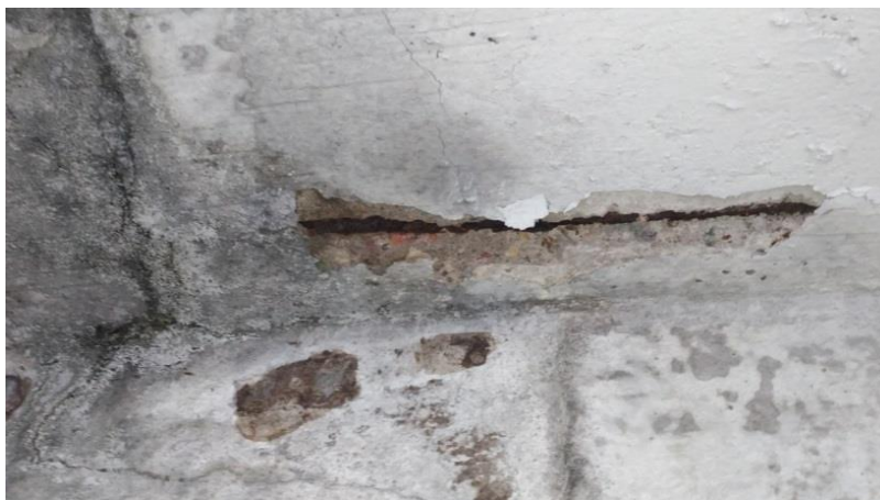
Figura 7. Exposição e corrosão de armadura sob a rampa do Prédio II
