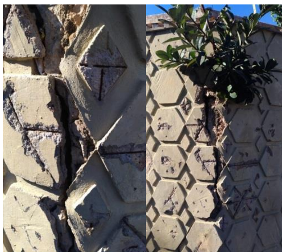
Figura 3. Rachadura no muro de arrimo do Espaço JK
