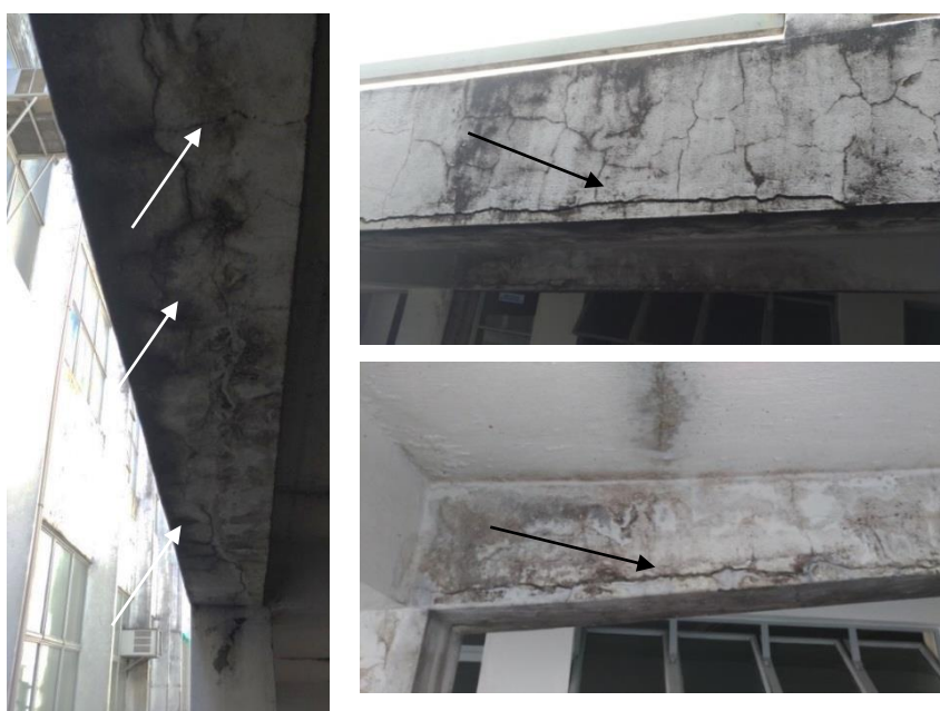
Figura 6. Corrosão de armadura sob a rampa do Prédio II
