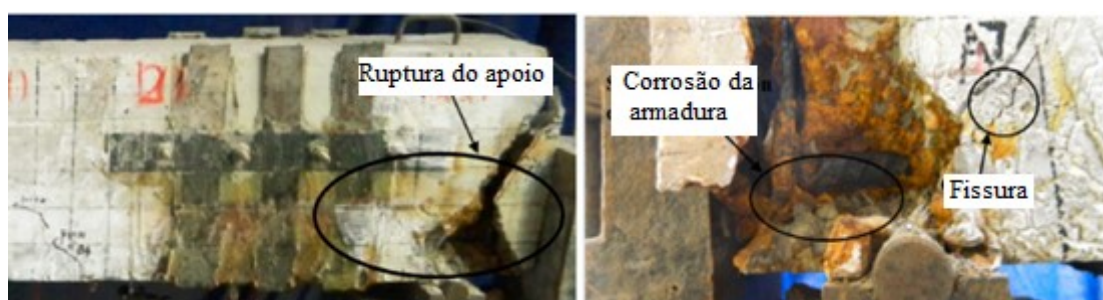
Figura 4. Ruptura de apoios das vigas com corrosão nas armaduras
